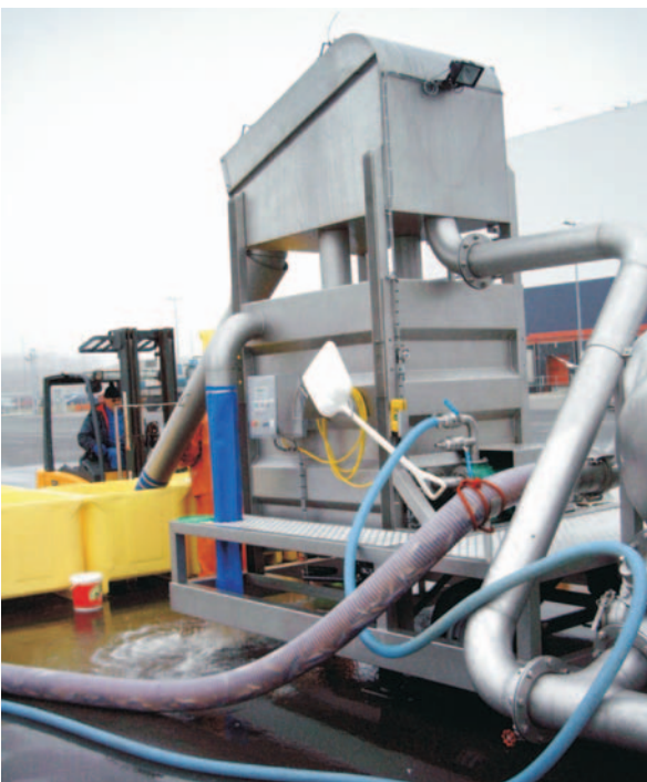
Abb. 4: Wasserabscheider mit Auffangtank für die Rückführung zum Fangschiff - Water separator with return water tank and exhaust hose to the cutter.
