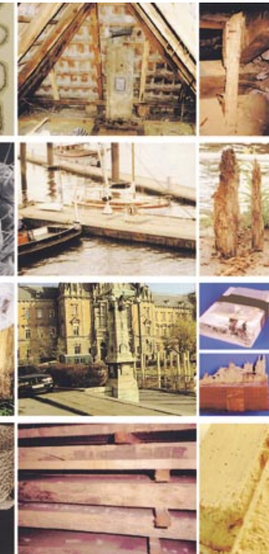
Abb. 3. Forschung an holzerstörenden Insekten und die jeweiligen Problembereiche mit Beispielen der Zerstörung: A. Hausbockkäfer ( Hylotrupes bajulus ); Pheromonuntersuchung und Tests der Monitoringfallen. - B. Werftbohrkäfer ( Nacerda melanura ); Lebensweise und Befall im Hamburger Hafen. - C. Gelbfüßige Bodentermite ( Reticulitermes flavipes ); Kartierung des Befalls in Hamburg. - D. Splintholzkäfer ( Lyctidae ); Morphologie und Verbreitung in Deutschland.
