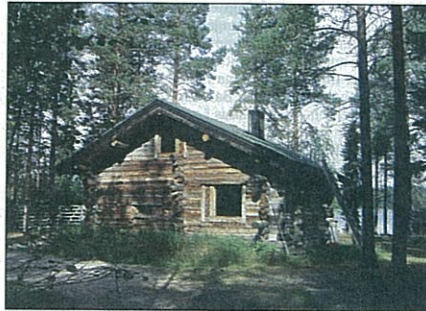
Holzblockhaus in Finnisch-Lapland (GK 3.1, vorausgesetzt keine nach oben liegenden Risse! Sonst GK 3.2)
