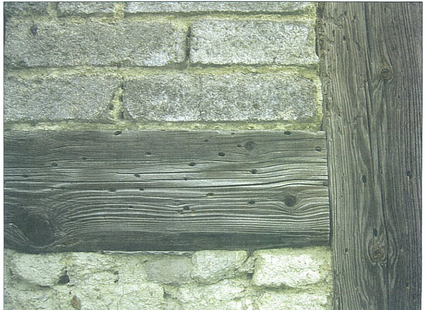
Abbildung 1 Hausbockbefall an einem Fachwerkhaus in Quedlinburg
