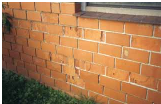
Abb. 8: Frostschäden am Verblendmauerwerk eines nachträglich mit Innen-dämmung versehenen Mastschweinstalles - Frost damages at the brick facade of a mast pig stable provided with additional internal insulation
