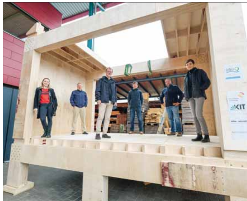
Das erste Modul eines Leichtholz-Gebäudes hat das Team um Andreas Löffler (vorne) in Karlsruhe aufgebaut.
