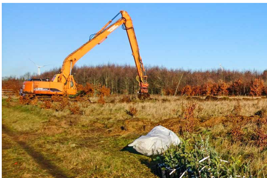
Abb. 3: Anlage der Pflanzplätze mit dem Langarmbagger. Reste der misslungenen Kultur wurden als Vorwald erhalten.
