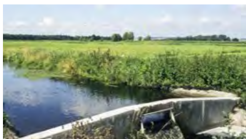
Abb. 1: Stauanlage an einem Entwässerungskanal © Dr. Ulrich Mäck, ARGE Donaumoos
