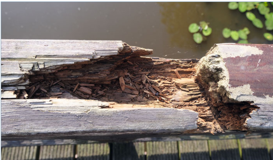
▲ Abb. 1: Ausgeprägter Braunfäuleschaden an einem Brückengeländer.
